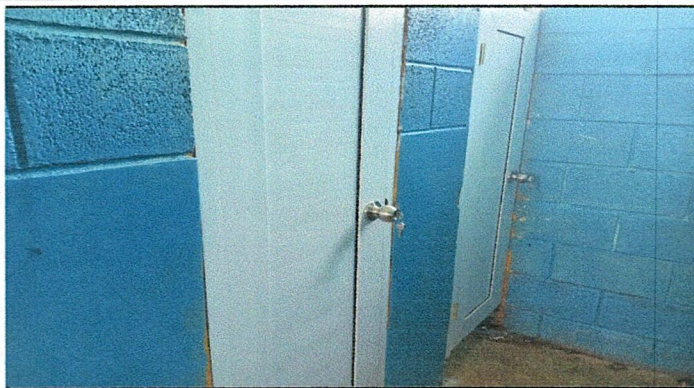
Foto 2: Asi quedaron las puertas de pvc en los baños
